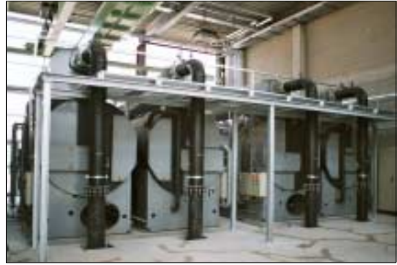
4 Stück Absorptionskältemaschinen heißwasserbeheizt Kälteleistung je Gruppe 2,65 MW
