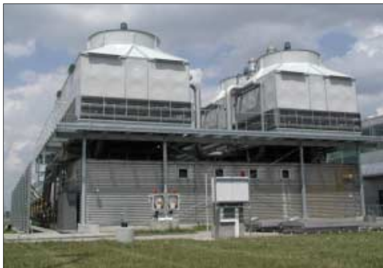
Rückkühlwerk offener Bauart, Gesamtleistung 60MW
