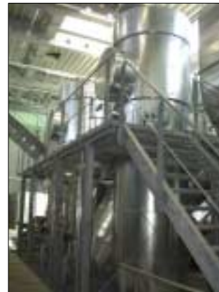
BHKW: 2 Stück Abhitzekessel
