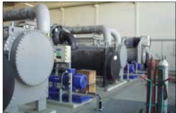
Turbo- Kältemaschinen \dot{Q}_0 = \text{je } 5,75 \text{ MW}
