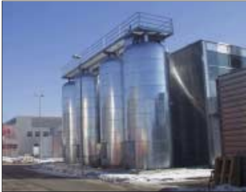
4 Stück Heisswasser-Wärmespeicher Inhalt je 90 m 3
