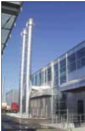
BHKW: 2 Stück freistehende Stahlschornsteine
